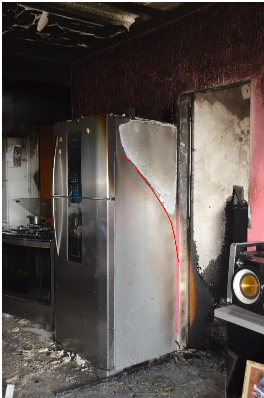
Figura 80 - A marca de queima na geladeira permitiu ao perito concluir que o quarto foi a zona de origem do incêndio
