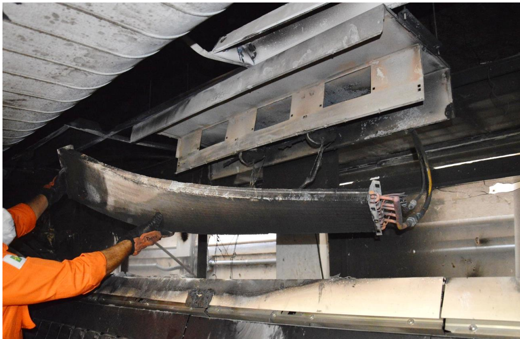
Figura 98 - Incêndios no equipamento de ar condicionado
