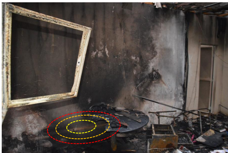
Figura 38 - Degradação da mesa (superfície horizontal)
