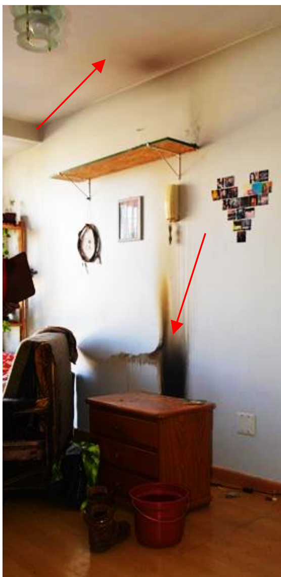
Figura 96 - As setas apontam duas marcas de combustão: a queima na parede sugere que o fogo tenha iniciado atrás do sofá, enquanto a marca no teto sugere que a origem do incêndio foi sobre a prateleira
