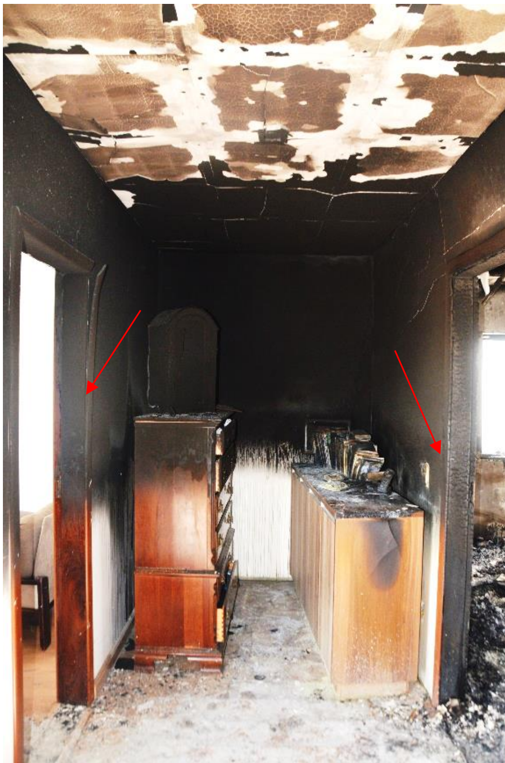
Figura 82 - Os padrões de queima coletados permitiram ao investigador concluir que a zona de origem foi o quarto da residência (seta à direita)
