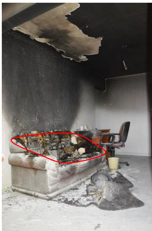
Figura 76 - O investigador concluiu que a zona de origem foi a sala de um apartamento. A partir do padrão de queima na parede, o foco inicial foi definido como a região sobre o sofá
