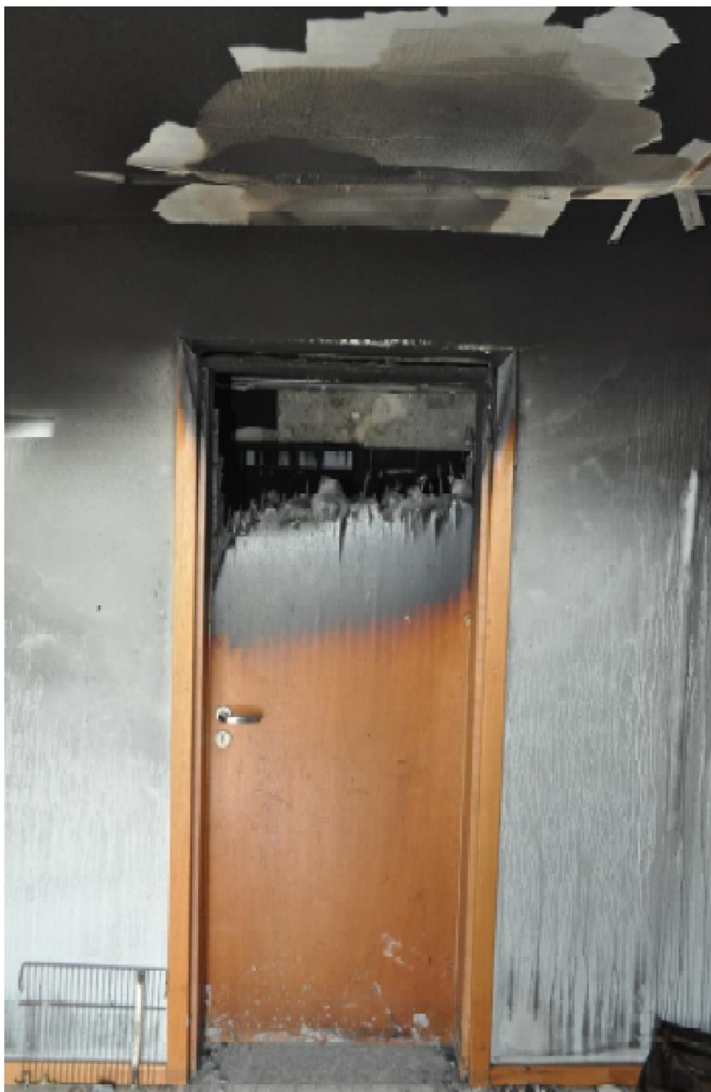
Figura 81 - O queima da porta e as marcas encontradas no teto indicaram ao perito que a zona de origem foi o ambiente situado atrás da porta (cozinha da residência)
