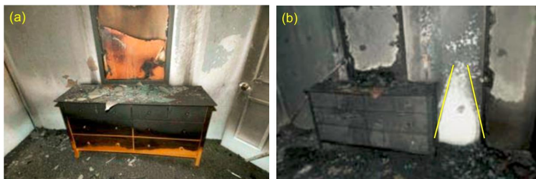
Figura 52 - Marcas de queima no ambiente nos tempos de 40 segundos (a) e 2 minutos e 30 segundos (b) após a generalização do incêndio ( flashover )
