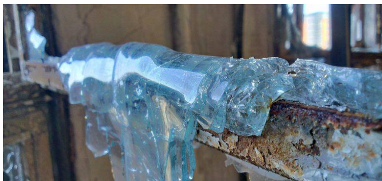
Figura 43 - Vidro derretido após um incêndio
