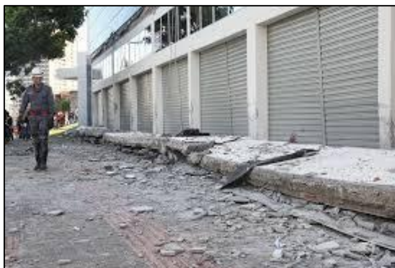
Figura 59 - Colapso de marquise
