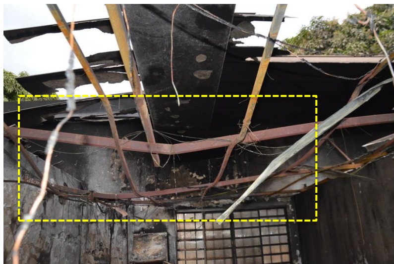
Figura 40 - Degradação na estrutura metálica de sustentação do forro
