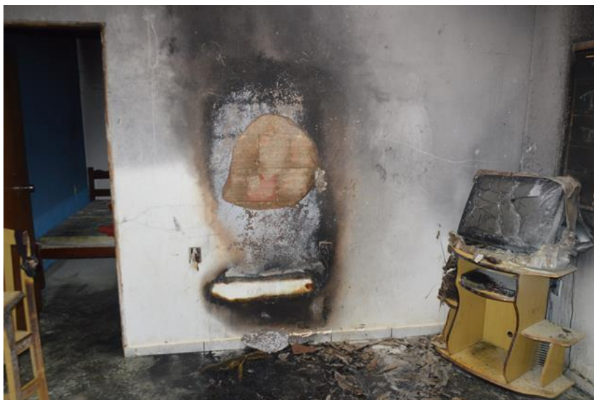
Figura 42- Marca de queima limpa na parede
