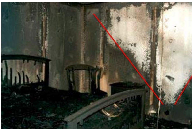
Figura 50 - Marca de queima no incêndio debelado 2 minutos e 30 segundos após a generalização do incêndio ( flashover )
