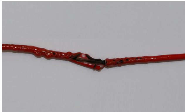
Figura 28 - Degradação do material isolante
