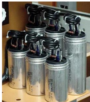
Figura 9 - Banco de capacitores: Equipamento elétrico capacitivo
