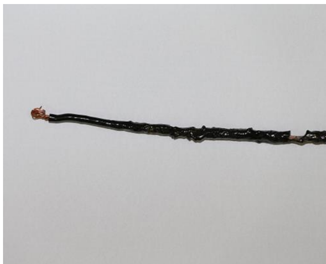
Figura 18 - Degradação do material isolante
