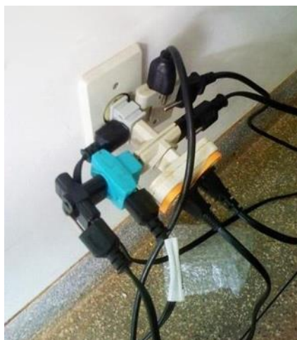
Figura 16 - Circuito de tomada com potencial para sobrecarga elétrica
