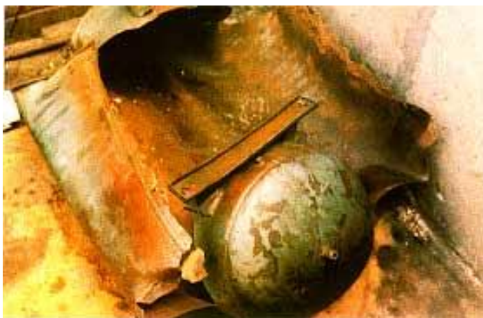
Figura 104 - Explosão em Reservatório de Compressor de Ar
