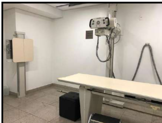
Figura II.1 – Imagem do Equipamento Raios-X Fixo.
