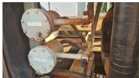
Figura 9 - filtros tubulação frigorígena.
