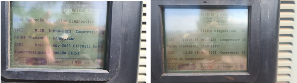
Figura 2 - falha apresentada no painel de controle do chiller 2 e 3 respectivamente.
