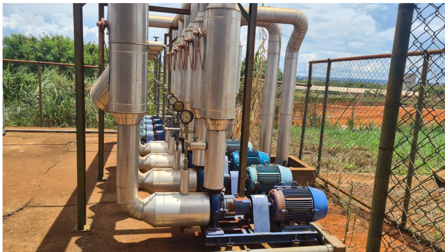
Figura 13 - fechamento hidráulico de bombas de água gelada.
