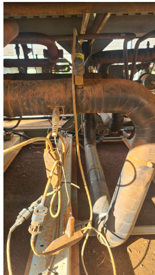
Figura 8 - sensor de temperatura de sucção defeituoso.
