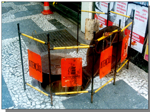
Figura 303: sinalização de uma estação elétrica subterrânea
