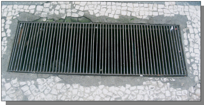
Figura 298: Boca de lobo
