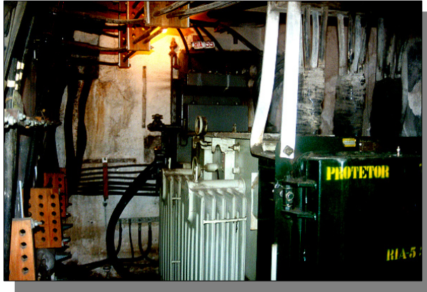
Figura 299: estação elétrica subterrânea.
