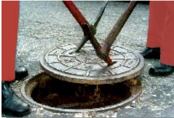
Figuras 308 e 309, respectivamente: técnica para abertura dos poços de visita e procedimento de abertura.
