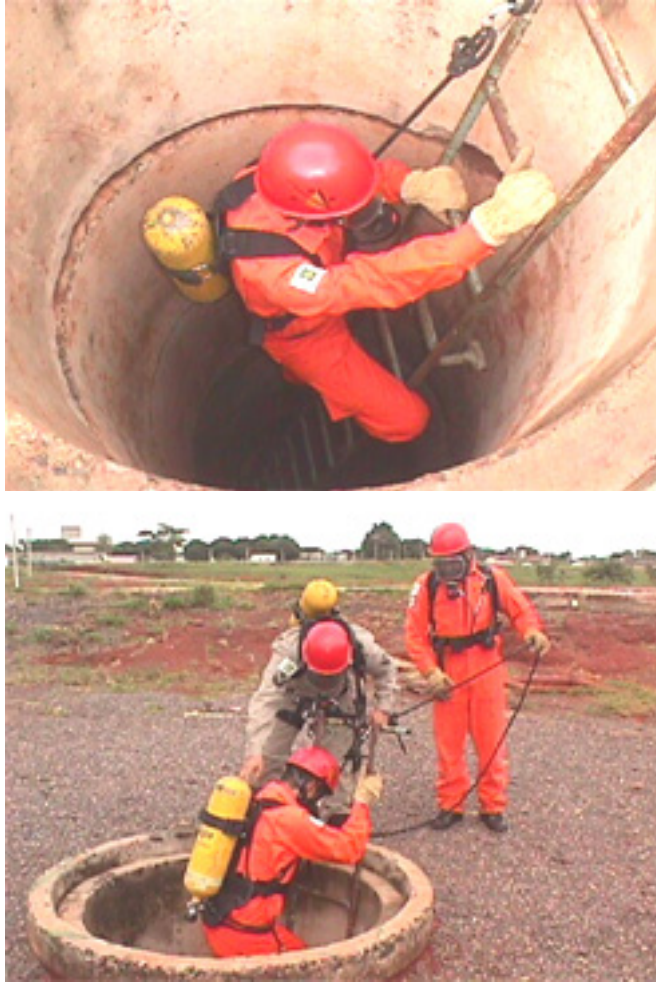
Figura 282: o acesso ao espaço confinado deve estar condicionado ao uso de EPIs.
