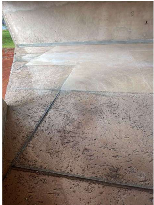
Figura 38: Piso sem granitina – 1º Pav. Bloco C
